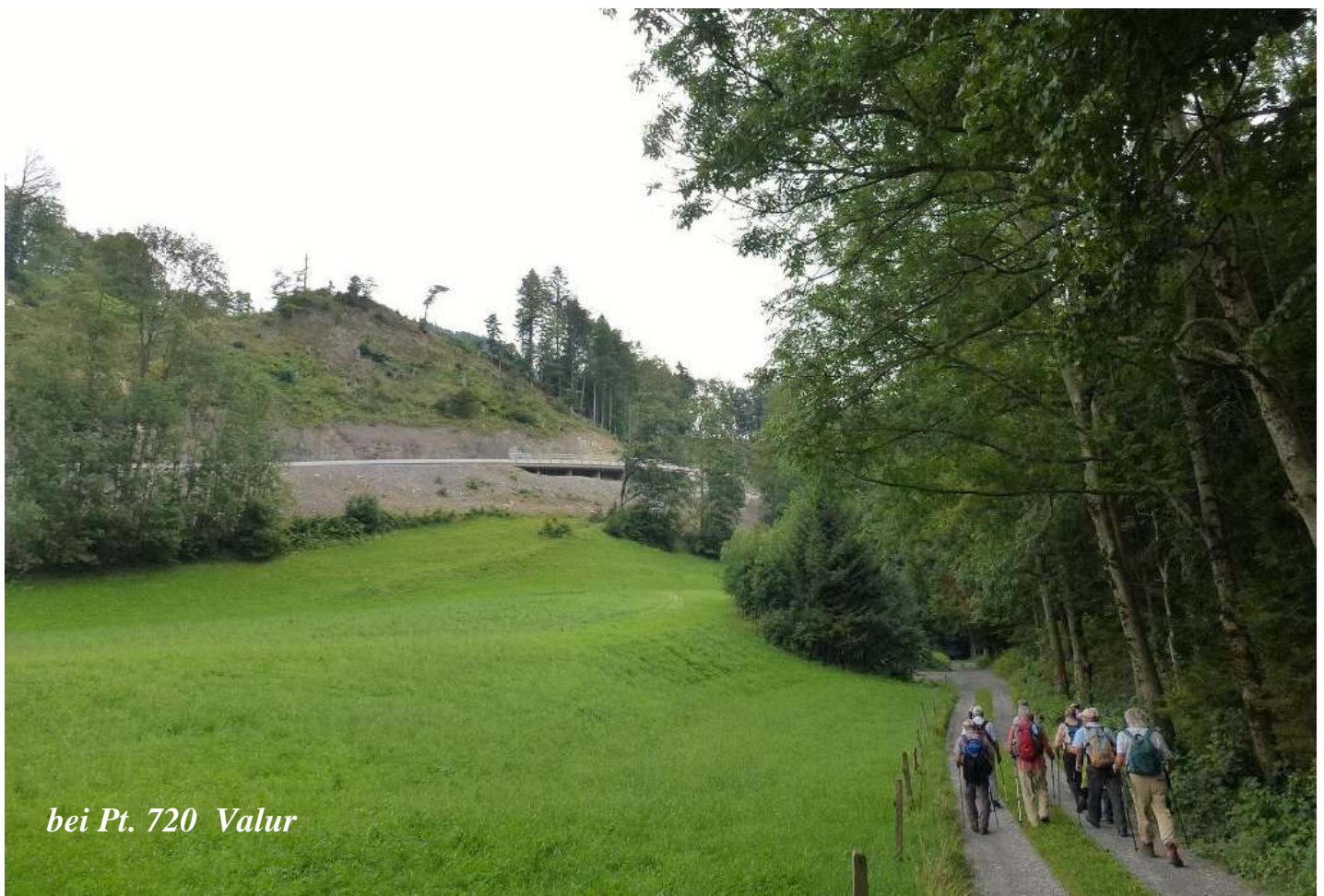
Beim Hinmarsch von Bad Ragaz her erkennen wir bereits die weit fortgeschrittenen Erdbewegungs- und Bauarbeiten für die neue Kantonsstrasse . Diese wird bereits ab Herbst 2014 bis zur Vollen- dung der Bauarbeiten an der Bogenbrücke (2017) als wichtige Bau-Erschliessungsstrasse dienen.
